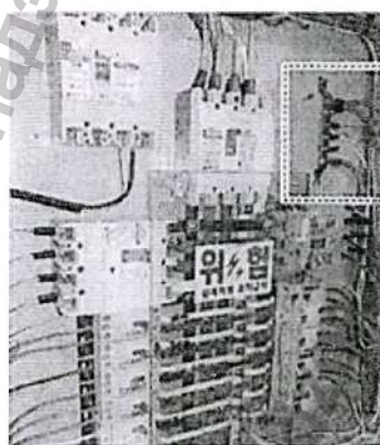
Заземленный источник питания
